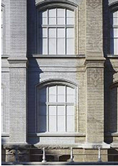
Außenfassade des Ostflügels mit Bestand und Ergänzung. Rechte Seite: Nahansicht eines in Kunststein gegossenen Fassadenteils über dem alten Untergeschoss
