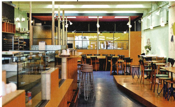
Umbau Bäckerei Kult, Basel Der Rückbau der Decke förderte alte Oblichter zu Tage. Rezyklierte Metallfenster in der neuen Holzständerwand eröffnen Blicke in die Backstube, ideal für Workshops, unterhaltsam für die Besucher der zweiten Filiale in der Stadt. Bild: Sarah Barth
