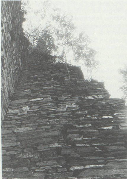
7 Augenfälligstes Zeichen, dass baldige Hilfe nottut, ist ein langer, vertikaler Riss in der südlichen Turmwand (7, Foto 1987).
