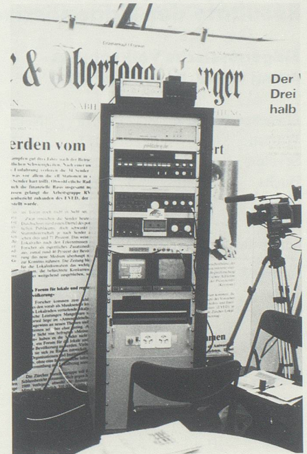
5. bis 13. September: Über diese Anlage werden an der « WIGA » in Buchs in einem Kurzversuch die ersten Lokalfernseh-Sendungen ins Werdenberger Kabelnetz eingespielen.
