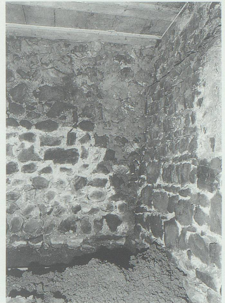
Ostecke im Keller (01) mit Baufuge zwischen dem Einbau (links) und der Stadtmauer (rechts).
