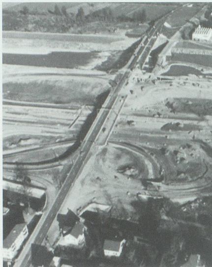
Der Anschluss Buchs im Oktober 1977: Die Notbrücke über den Rhein ist teilweise abgebrochen, Dammschüttungen sowie Trasse und Rampen des Autobahnanschlusses sind kurz vor der Fertigstellung; noch in Arbeit sind Fahrbahn und Brücken der Unterführung beim Kanalweg. Bild: Baudepartement des Kantons St.Gallen.
