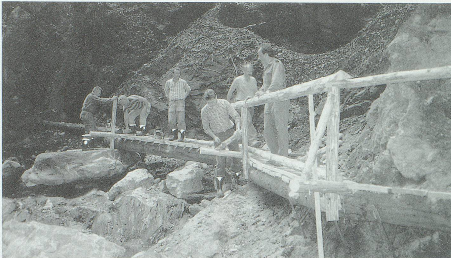
Das schwere Unwetter im August 1989 zerstörte den romantischen Schluchtweg durch das Geissbergobel bei Sevelen. Noch im gleichen Jahr wurde er unter der Leitung von Jakob Giger mit tatkräftiger Arbeit der Feuerwehr und einer Lehrlingsgruppe wieder hergestellt. Bild: Jakob Giger, Sevelen.
