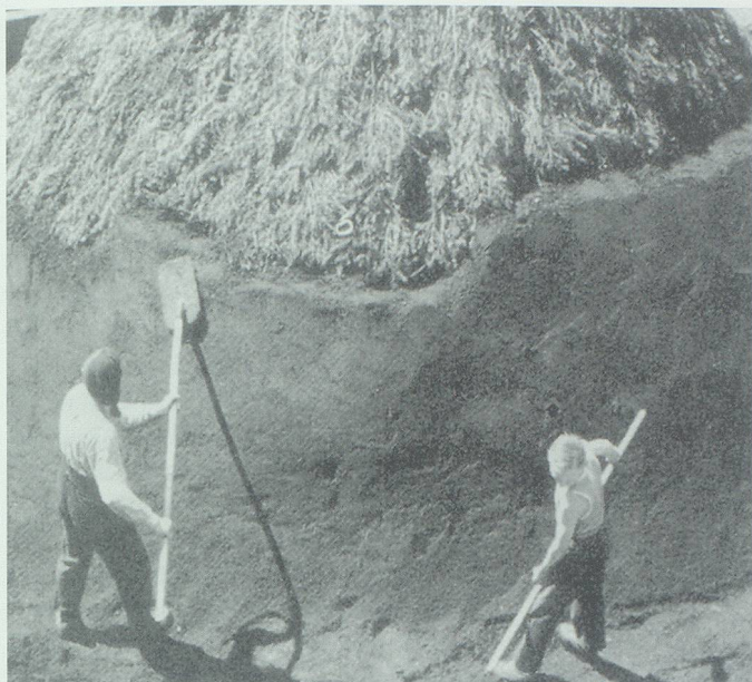
Über dem Mantel aus Tannenreisig wird die angefeuchtete Löschi aufgetragen. Aus Gall 1/2003.
