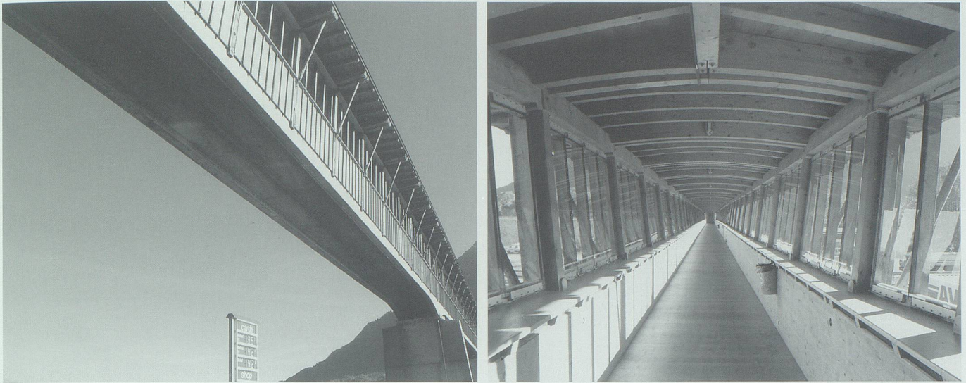
Abb. 4a/b. Fussgängerüberführung über die A 13 bei der Raststätte Fösera/Sevelen. Bilder: Hans Jakob Reich, Salez.
