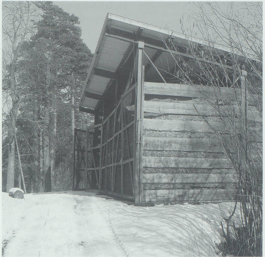
Die Holzschnitzel-Lagerhalle der Ortsgemeinde Wartau beim früheren Wasenplatz weist ein Volumen von 450 Kubikmetern auf und dient als Pufferlager.
