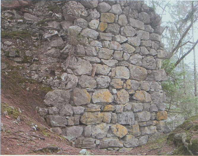
Abb. 15: Der Aussenmantel des Turms auf der Wildenburg bei Wildhaus ist aus mächtigen Steinblöcken lagerhaft aufgemauert worden. Der Mörtel ist zum Teil bis weit ins Mauerinnere hinein ausgewaschen.
