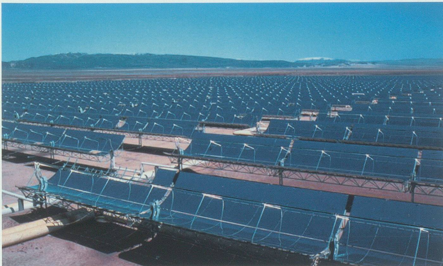
Spiegelrinnenkraftwerk in Kalifornien/USA. Public-Domain-Bild
