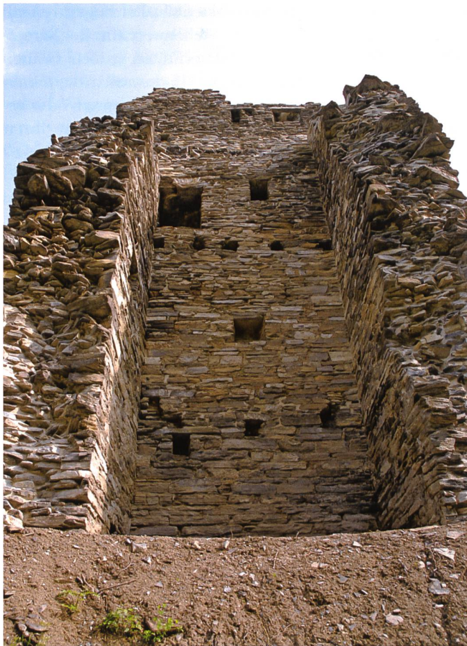
Die Burg Hohensax ist die einzige Burg in der Region Werdenberg, die kriegerischen Ereignissen zum Opfer gefallen ist: 1446, im Alten Zürichkrieg, eroberten und schleiften sie die Appenzeller und brachten eine Seite des Bergfrieds zum Einsturz. Foto Hans Jakob Reich, Salez
