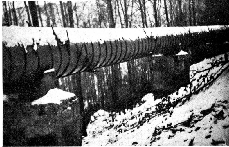
Ueber dem Gelände auf Mauerpfelern verlegte Holzrohrleitung.
