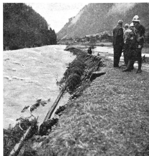
Abb. 5 «Balm» (km 0,500). Anriss rechtsufrig.
