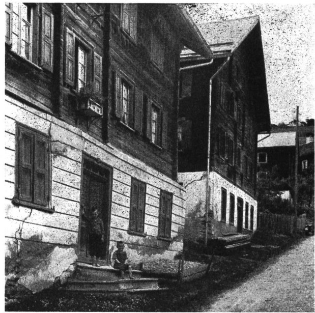
Abb. 6 Häuser in Peiden-Dorf, die immer wieder reparaturbedürftig sind. Photo: Jules Geiger, Flims.
