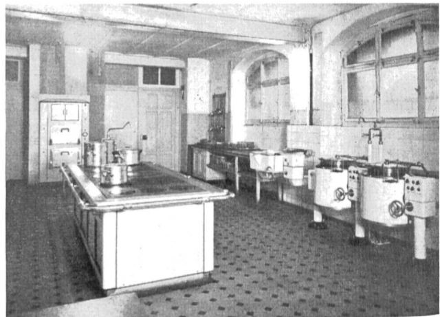
Fig. 3 Der Herd, die beiden Kippkessel, die Kippbratpfanne und im Hintergrund der Brat- und Backofen.
