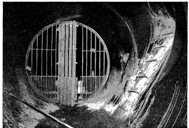
Abb. 14 Druckstollen: Rechen und Wasserschloßeinmündung.
