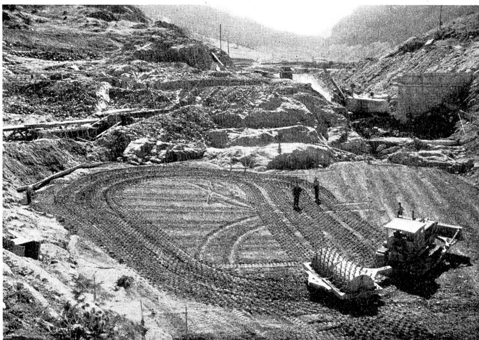
Abb. 21 Verdichten des Kernmaterials mit Schafffußwalzen von 18 t Gewicht und 30—40 kg/cm 2 spezifischer Pressung Photo H. Steiner, St. Moritz
