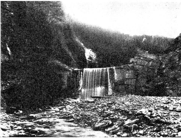
Abb. 7 Betonsperre durch Bergdruck teilweise zerstört, im Nolla, oberhalb Thusis
