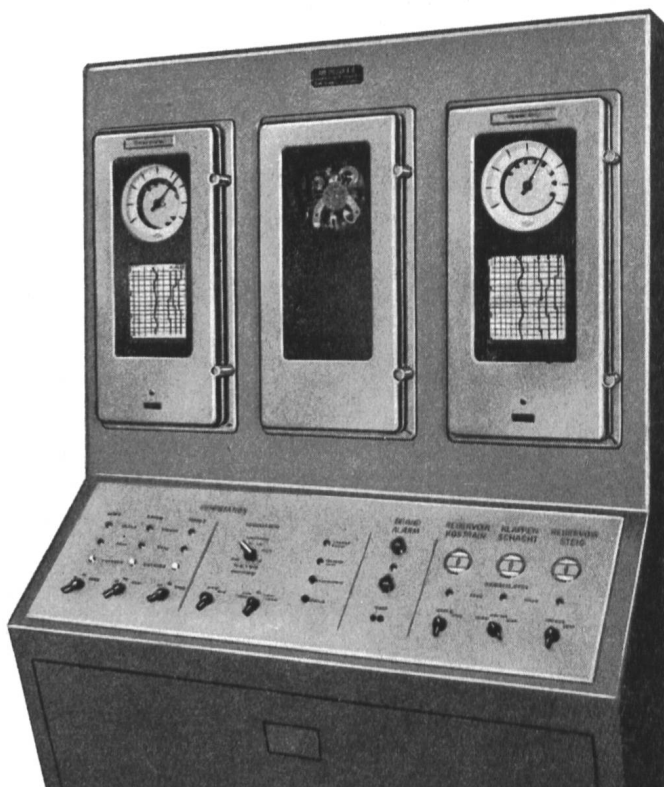
Kommandopult einer Wasserstandsfernmeldeanlage mit automat. Pumpenfernsteuerung
