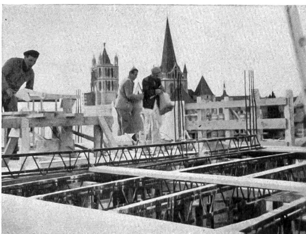
Geschäftshaus mit FIX-Trägern
