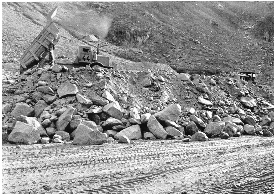
Bild 5 Ausgeprägte Entmischung des Materials bei 4,0 m Schütthöhe.
