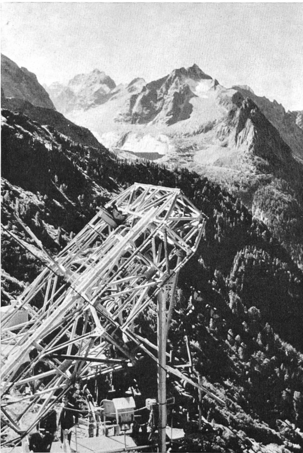
Bild 3 Baustelle Murtaira, Blick auf Scioragruppe und Piz Cacciabella, an dessen Fuß die Staumauer Albigna
