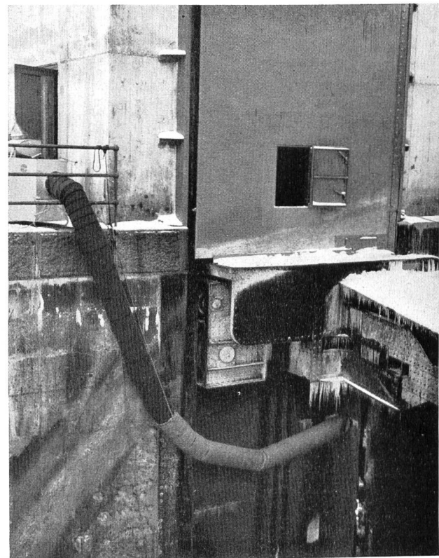
Bild 10 Wärmezuführung zu den Gleitbahnen einer Schütze beim Kraftwerk Ryburg-Schwörstadt (Photo G. Moll)
