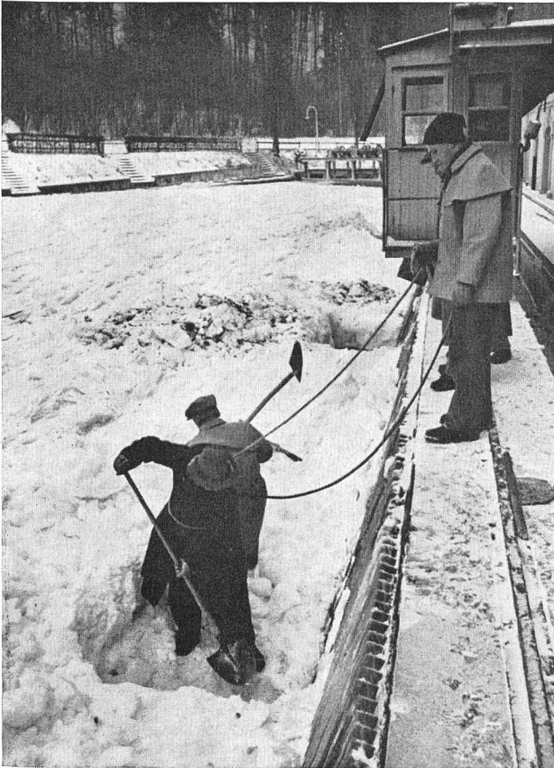
Bild 6 Rechen-Enteisung beim Kraftwerk Ruppoldingen (Photo ATEL)
