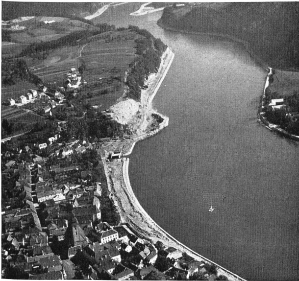
Bild 23 Bild des abgesprengten Schwallecks mit Felswall
