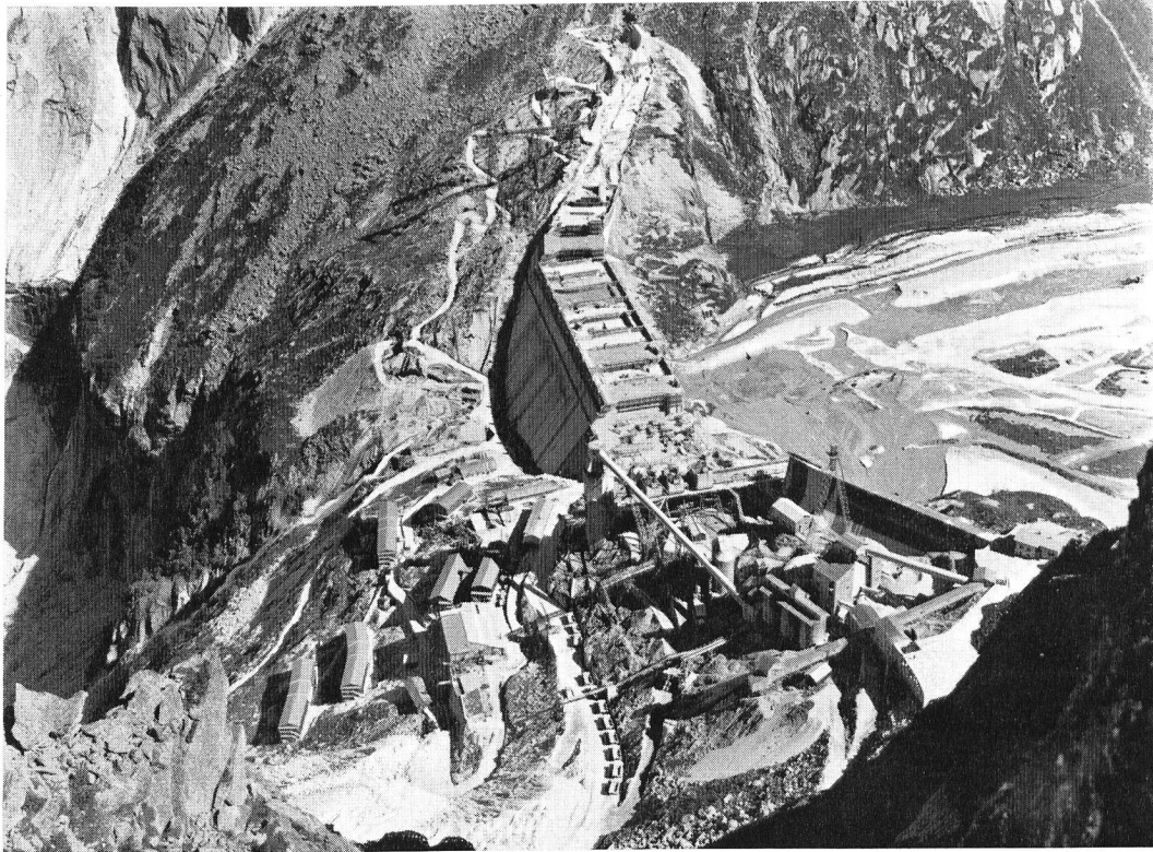
Bild 16 Baustelle der Staumauer Albigna, auf 2100 m ü. M., Bauzustand September 1958 (Photo Plattner, St. Moritz)
