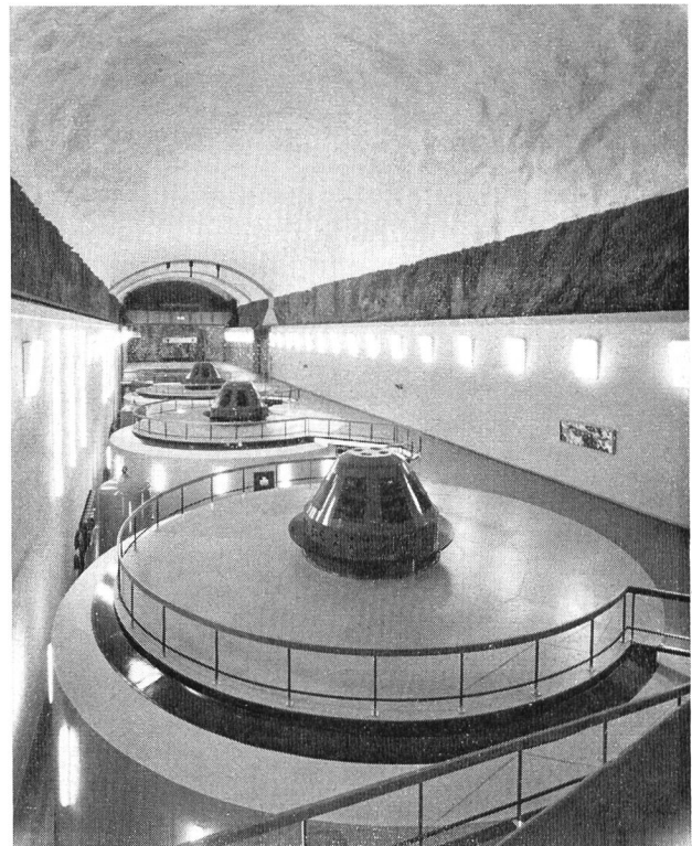
Bild 36 Kavernenzentrale Stornorrfors der größten Wasserkraftanlage Schwedens (375/500 MW; 1,95/2,10 Mrd kWh); die Betonverkleidung reicht nur bis zur Höhe der Kranbahn. (Aufnahme Oktober 1959)
