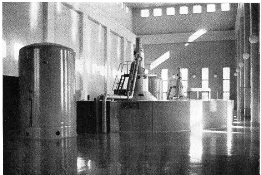
Bild 54 Maschinenhalle des Kraftwerks Isohaara; alle Anlageteile sind in hellen gutharmonisierenden Pastellfarben angelegt und wirken sehr geschmackvoll.
