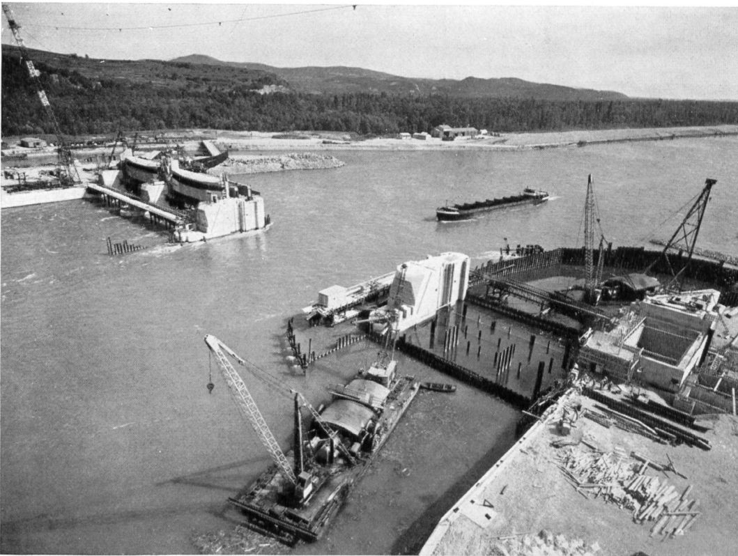
Bild 8 Bau des Stauwehres der Stufe Marckolsheim bei Burkheim unterhalb Breisach, 5. Stufe des Ausbaues Basel—Straßburg für Wasserkraftnutzung und Schifffahrt. Aufnahme August 1960, gleiche Stelle wie bei Bild 1 (Photo H. Baranger, Paris)
