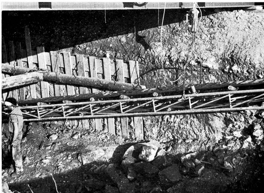
Fig. 7 Centrale de Veytaux. Passage du canal de fuite sous les voies du chemin de fer. Effet des injections de coulis de bentonite suivies d'injections de ciment, dans les remblais et la moraine. (Photo Jean Charpié, Lausanne)
