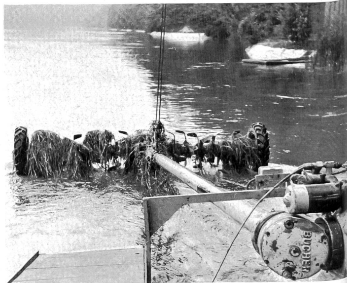
Bild 10 Kraftwerk Rheinau, Algenfräse in Betrieb
