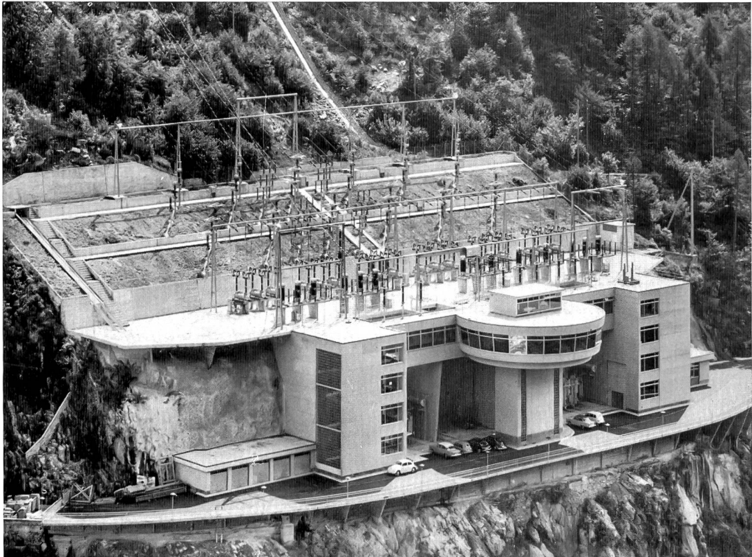
Fig. 4 Bâtiments extérieurs et station à ciel ouvert 150 kV — Vue d'ensemble
