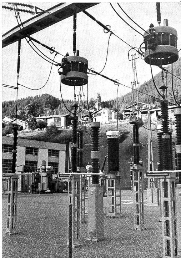
Bild 6 Teilansicht der Freiluftschaltanlage und Zentrale Filisur; im Hintergrund Dorfpforte von Filisur
