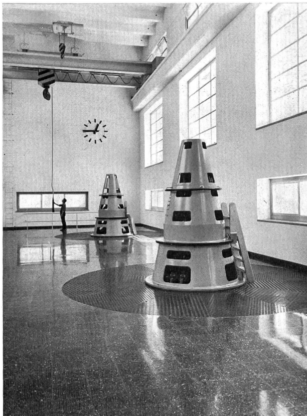
Bild 5 Innenraum der Zentrale
