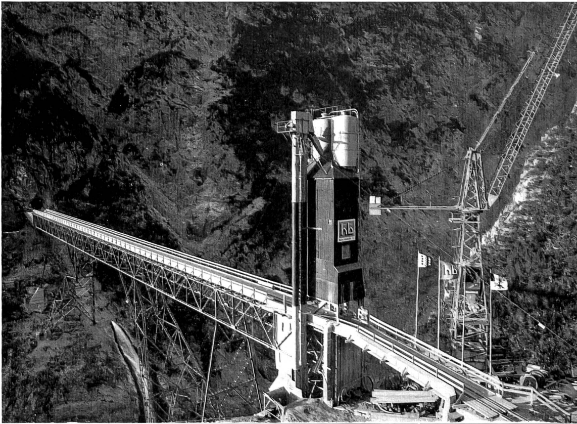
Druckstollen Livigno-Ova Spin Dienstbrücke über den Spöl
