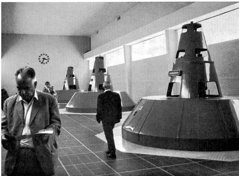
Bild 8 In der Kavernenzentrale Verzasca, die 220 m senkrecht unter der Schaltanlage liegt.
