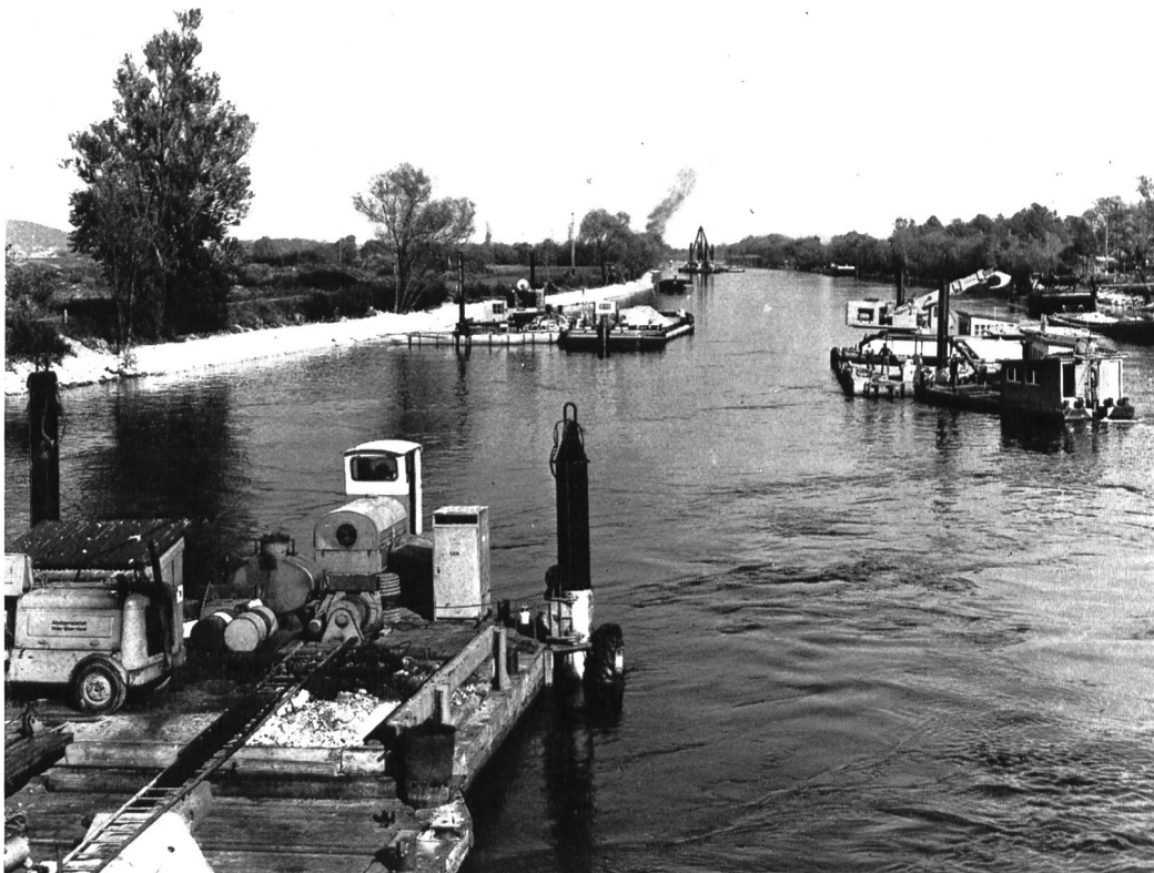
Bild 5 Zweite Juragewässer- korrektur; Nidau-Bürenkanal, Baggerarbeiten zur Vertiefung des Kanal- profils (Photo II. JGK)
