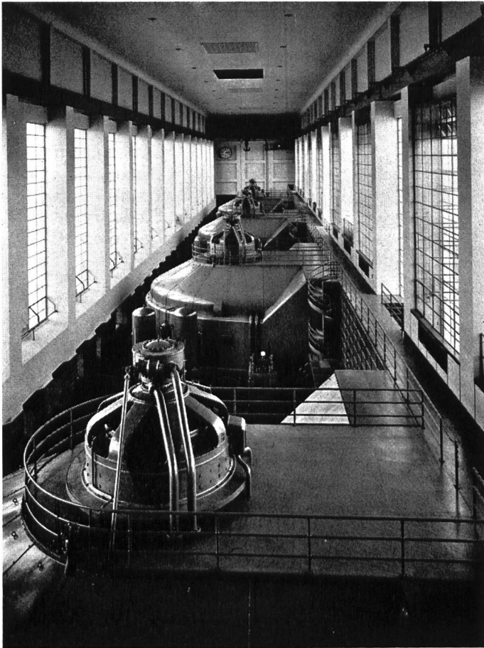
Kraftwerk Ryburg-Schwörstadt AG, Rheinfelden (Schweiz)
