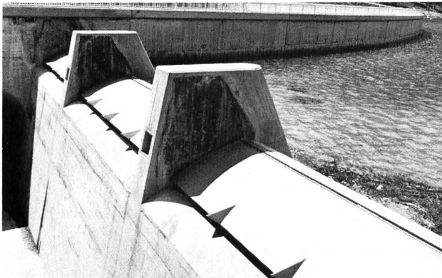
Bild 11. Hochwasserentlastung des Staueses Isola mit drei Stauklappen. Beachtenswert ist die Gestaltung der die Klappen umgebenden Pfeiler. 1959.
