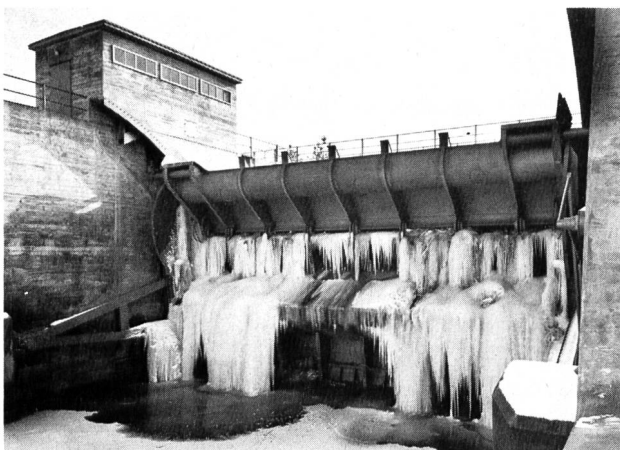
Bild 12. Stauwehr Wildegg-Brugg. Eisbehang an einer der drei Segmentklappenschützen zufolge Undichtigkeit, 1949.
