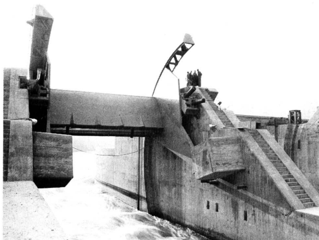
Bild 17. Stauwehr Reichenau I. Dreiteilige Doppelsegmentklappenschütze. Ansicht in zusammengelegter, gehobener Lage von Unterwasser. 1960/61.
