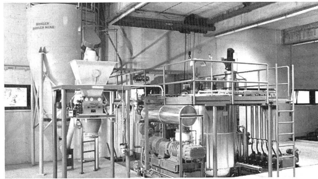
Bild 1. Die Bühler-Schlamm-trocknungsanlage ZTD-2/6, wie sie in der Abwasserreinigungsanlage Altenrhein installiert ist.
