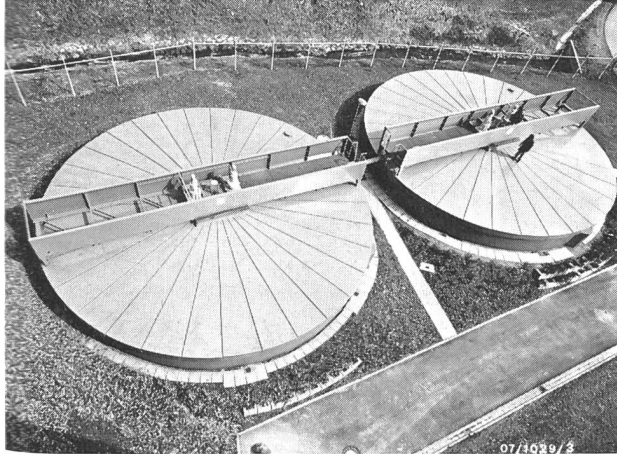
Kunststoffabdeckungen einer Abwasserreinigungsanlage (Durchmesser je 16 m).
