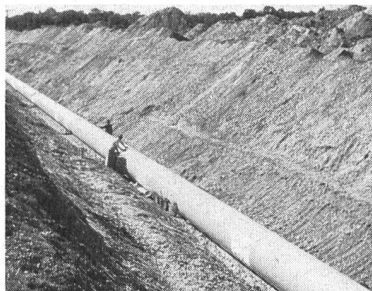
Rohrleitung für aggressives Abwasser Ø 1200 mm
