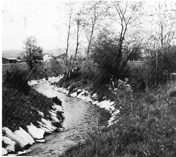
Figura 4. Lavori di correzione del ruscello Uerke presso Kölliken, Cantone Argovia (profilo trasverso = 30 m 3 /s).
