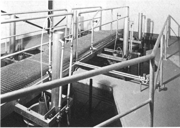
Bild 6. DynaSand-Filter der ARA Maur/ZH. 6 Filter à je 3 m 2 . Anlageleistung 288 m 3 /h.
