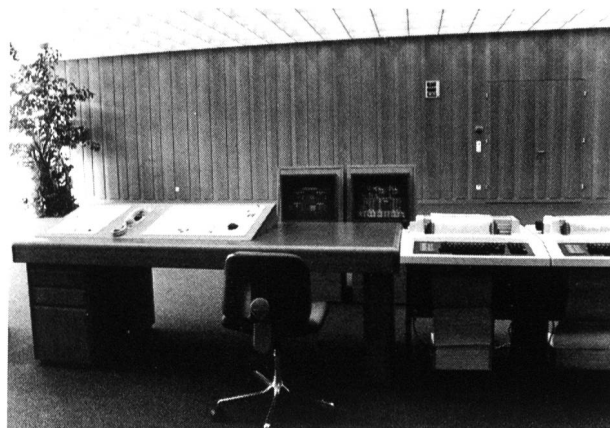
Zentrale einer Netzleitstelle mit Telegyr LS2000.
