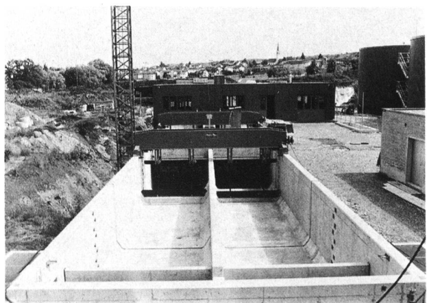
Bild 3. Die neuen Vorklärbecken der Abwasserreinigungsanlage Rietwiesen. Dahinter der Sandfang und das Maschinenhaus.
