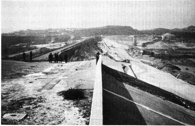
Figure 2. San Fernando : tremblement de terre de 1971, rupture de la digue inférieure de San Fernando.
