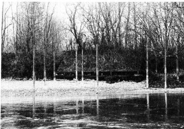
Bild 2. Zeugen der Ufererosion. Die ehemals bodenbündigen Betonsöckel der Panzersperre oberhalb Rheinklingen wurden in Ufernähe freigespült und ragen heute, nach etwa 40 Jahren, 40 bis 50 cm aus der Kiesbank heraus.
