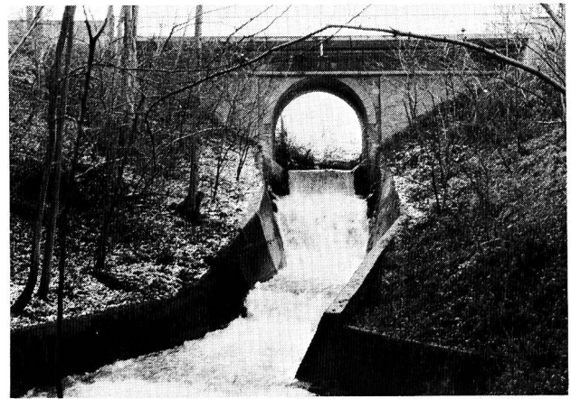
Bild 1. Beim Kleinkraftwerk Roggwil wird ein natürlicher Gefällsprung von 10 m der Langeten bei der Gullenbrücke genutzt.
