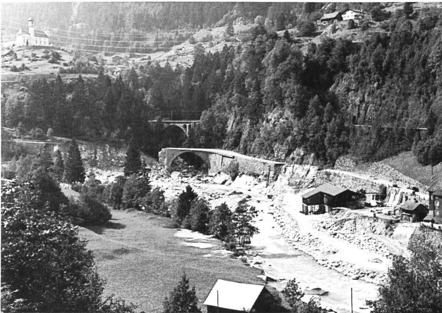
Bild 16. Mehrfach zerstörte Kantonsstrasse unterhalb von Wassen. In Bildmitte befindet sich die Einmündung der Meienreuss. Das Reussbett war nach dem Hochwasser nahezu doppelt so breit. Hohe Stützmauern der Kantonsstrasse (alten Gotthardstrasse) wurden unterspült und stürzten ein. Die Sägerei wurde stark beschädigt. Die Wiederherstellungsarbeiten sind im Gange. (Foto G. Gerig, Kantons-Forstmeister, Altdorf)
