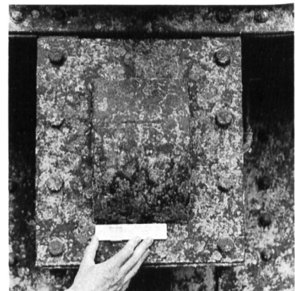
Bild 5. Bewuchs durch einen Süßwasserschwamm am Wehrverschluss.
